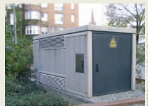
Estación de red local de media tensión
