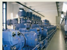
Instalación de distribución interior de 110 kV
