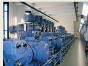
110-kV indoor switchgear
