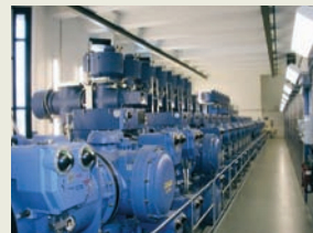
110-kV indoor switchgear
